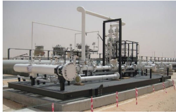
Figure 1.2 : Skid de comptage de GPL (Hassi Messaoud).
